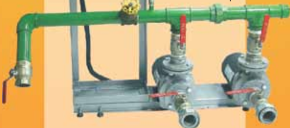
Sistema de bombeamento com pressão constante através da utilização de inversor de frequência
